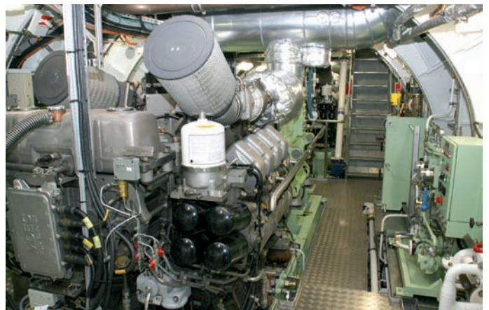
Vier MTU-Diesel-Aggregatesätze leisten zusammen mehr als 3.000 kW
